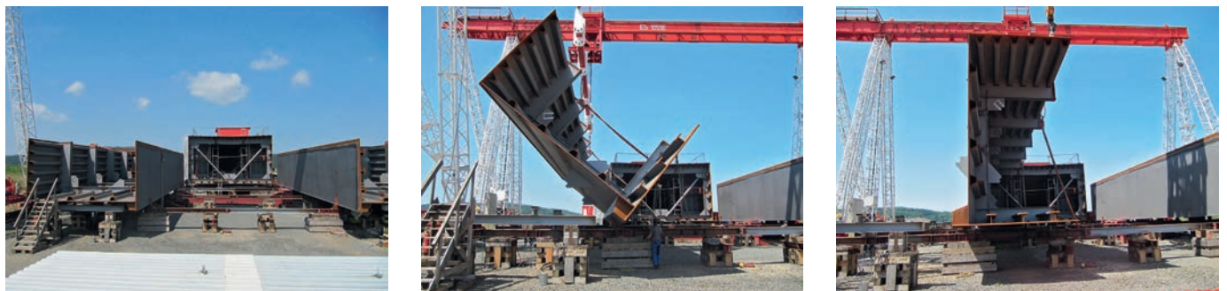
Bild 11. Zusammenbau des Hohlkastens auf dem Vormontageplatz und Aufkanten Fig. 11. Assembly of the hollow box and edging
